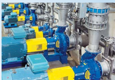
◀ Pompe di processo per pompaggio impasti nell'industria della carta e della cellulosa
